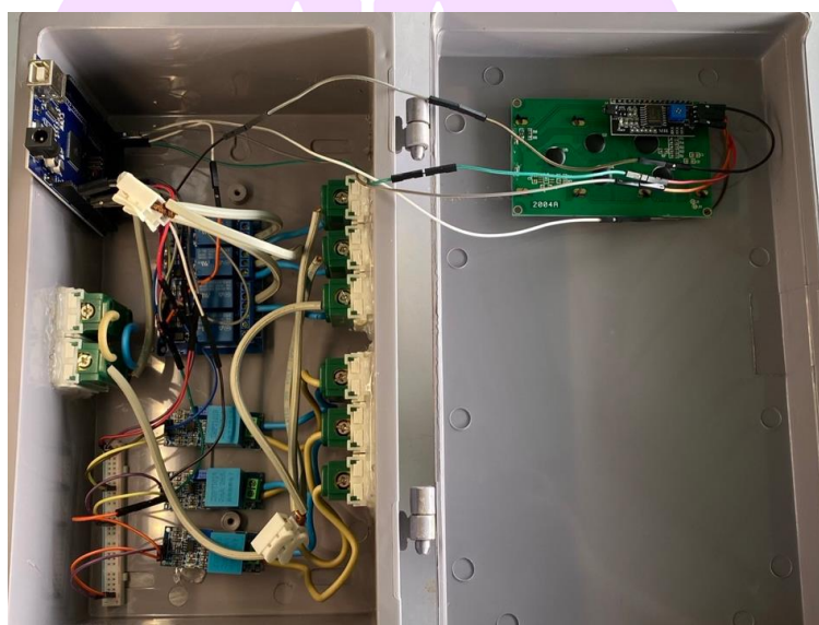
(ก) ภายในอุปกรณ์ควบคุม
