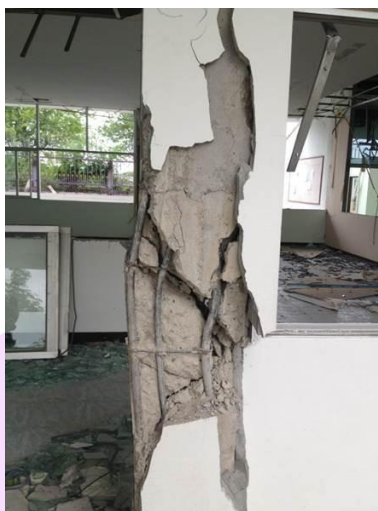
ภาพ 1 การวิบัติที่เกิดจากแรงเฉือนในเสาคอนกรีตเสริมเหล็ก โรงเรียนพานพิทยาคม จังหวัดเชียงราย
