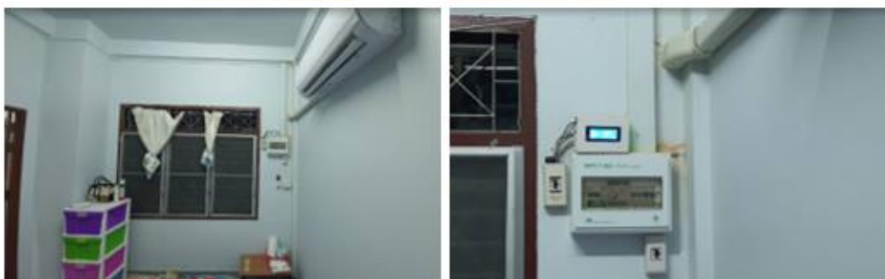
ภาพ 63 การติดตั้งสมาร์ตมิเตอร์บ้านพักอาศัยทั่วไป
