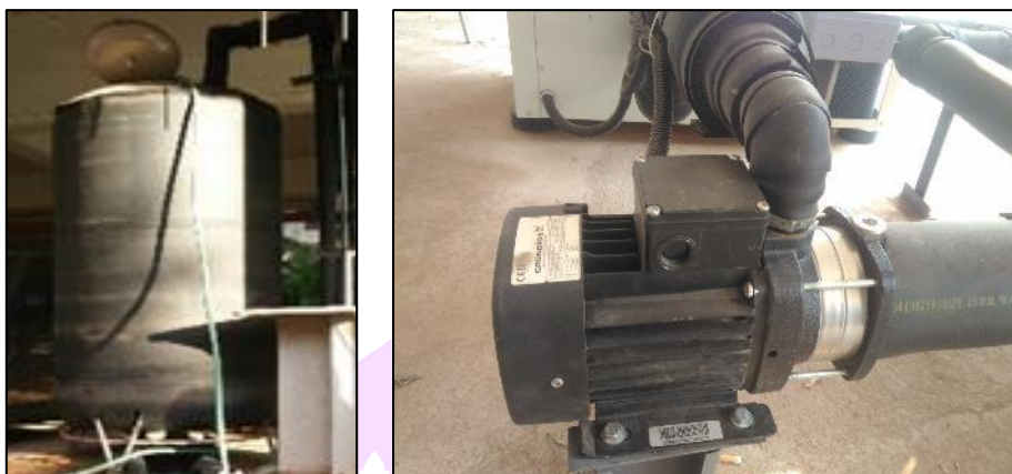
ภาพ 47 ชุดถังเก็บน้ำเย็น (Chilled Water Storage Tank, CST) และ เครื่องสูบน้ำเย็น (Chilled Water Pump, CHP)
