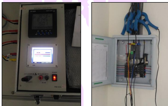
ภาพ 34 การตรวจวัดและบันทึกค่าปริมาณและระดับพลังงานในระบบปรับอากาศ
