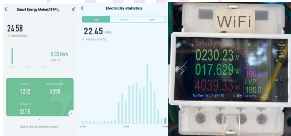
ภาพ 35 อุปกรณ์เครื่องมือวัด Wi-Fi Smart Switch Energy Meter
