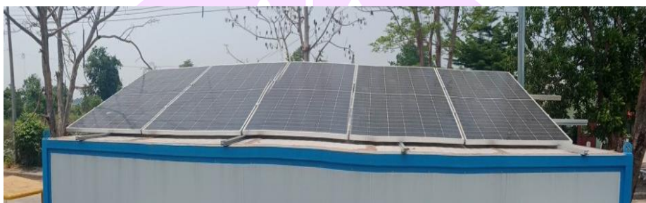
ภาพ 36 PV Mono half cell ขนาด 540 W ต่ออนุกรม ขนาด 2.7 kW ในสวนพลังงาน
