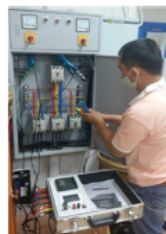
รูปที่ 2 ติดตั้งอุปกรณ์เก็บข้อมูลการใช้ไฟฟ้าของอาคาร
