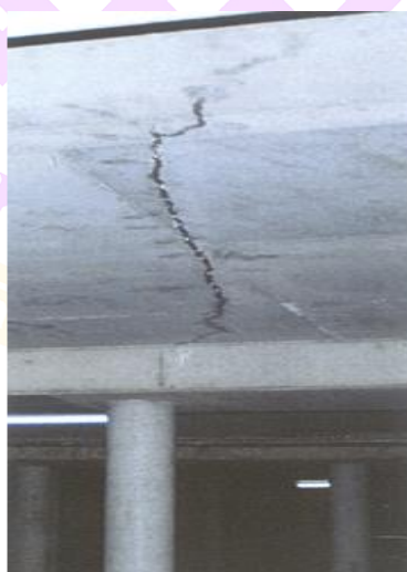
ภาพ 9 การเกิด Drying Shrinkage Crack ของคอนกรีตโครงสร้างพื้น
