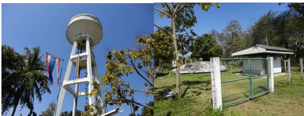
ภาพ 23 แสดงระบบประปาชุมชนศรีชัยมงคล
