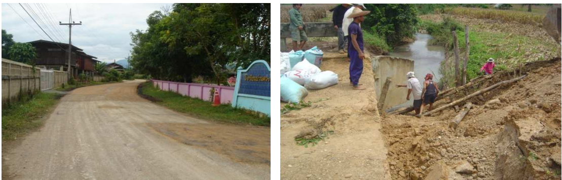
ภาพ 2 แสดงการซ่อมแซมความเสียหายจากผลกระทบน้ำกีดเซาะตลิ่งลำน้ำขาน
