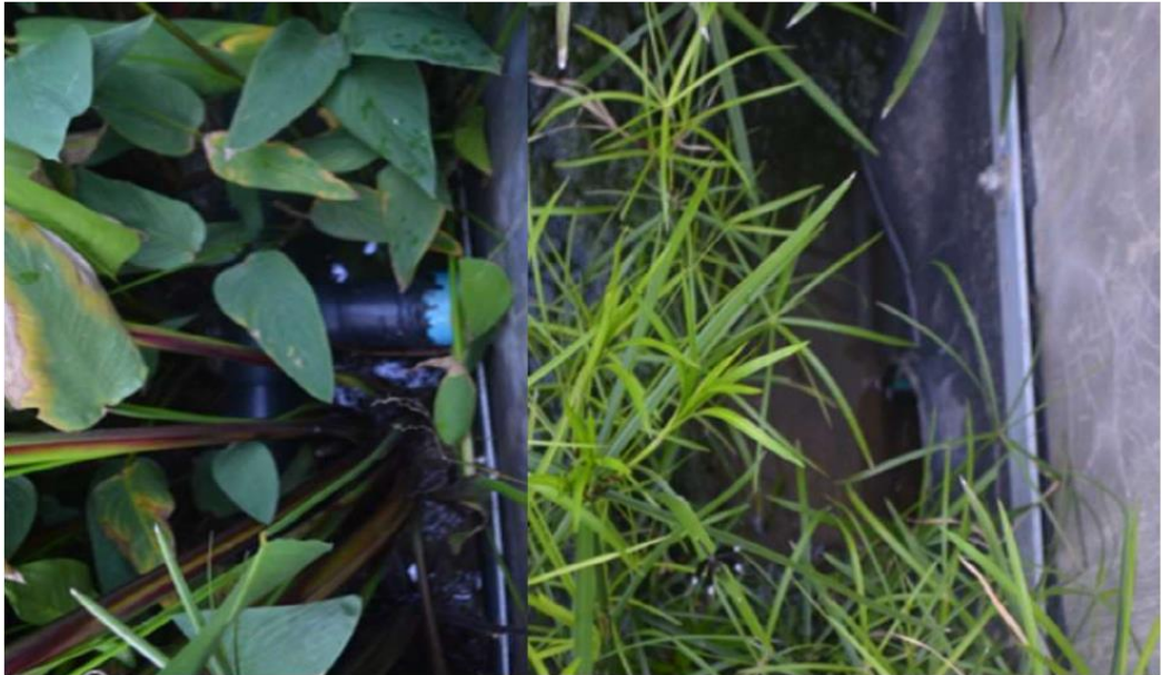
ภาพ 12 ท่อน้ำเข้าระบบ (FWS)
