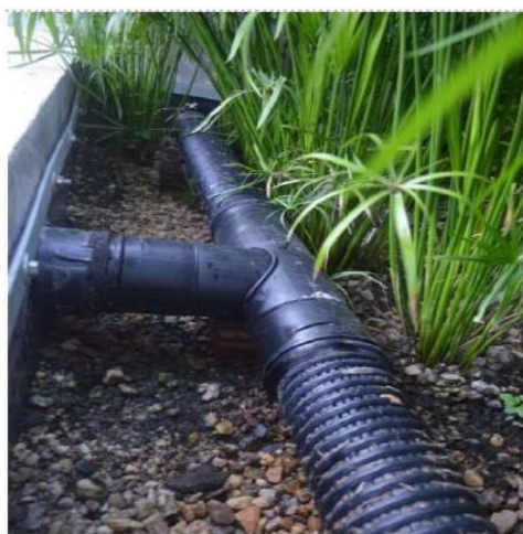
ภาพ 7 ท่อน้ำเสียเข้าระบบ HF
