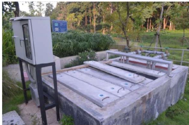
ภาพ 5 บ่อพักน้ำเสีย
