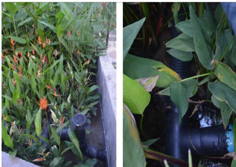
ภาพ 10 ท่อน้ำเสีระบบ (VF)
