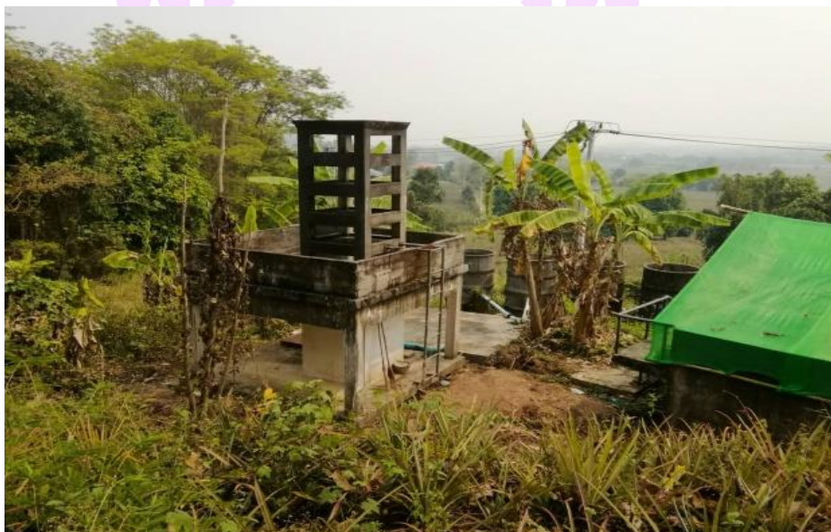
ภาพ 21 แสดงระบบประปาหมู่บ้าน ขนาด 10 ลูกบาศก์เมตรต่อชั่วโมง ของบ้านโป่งน้ำตก
