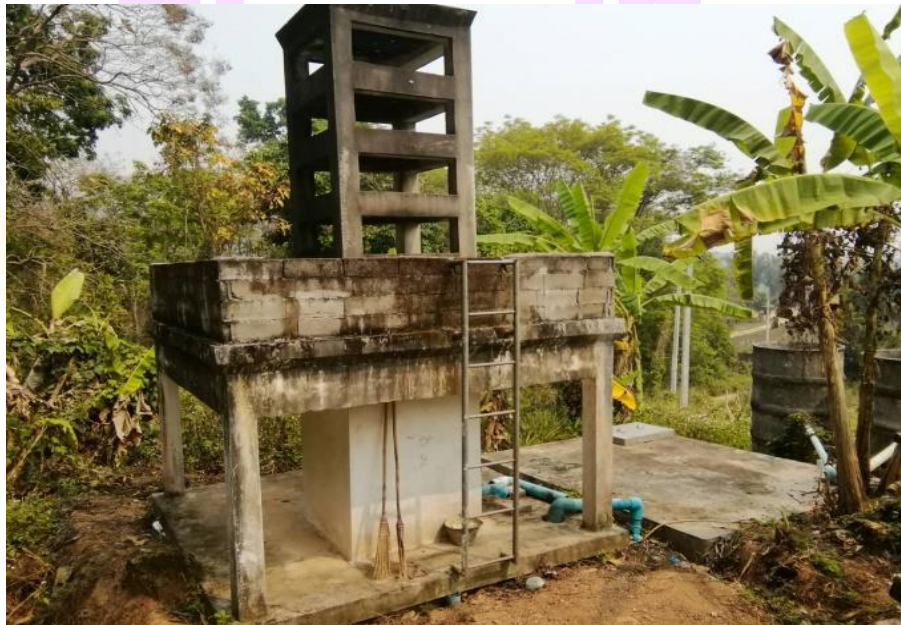
ภาพ 23 แสดงระบบประปาถังตกตะกอนและถังพักน้ำของระบบประปาหมู่บ้าน บ้านโป่งน้ำตก
