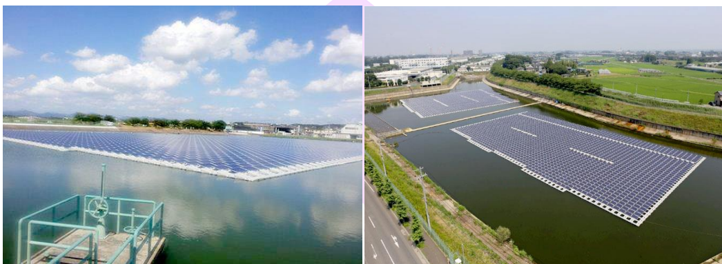
ภาพ 18 แผง Solar Cell ลอยน้ำ
