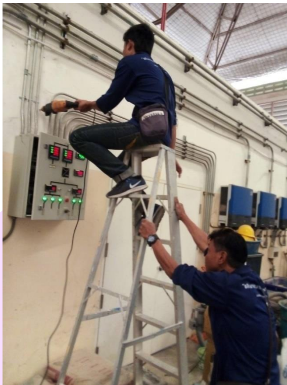
ภาพ 62 การติดตั้งเครื่องวัดค่าพลังงานไฟฟ้า (Power Meter) จำนวน 1 ชุด ตรงบริเวณ สถานีหม้อแปลงไฟฟ้าระบบ (Unit Substation) เพื่อการใช้ไฟฟ้าของกลุ่มอาคาร ได้แก่ ห้องประชุม Power house อาคารศูนย์การเรียนรู้ทางด้านพลังงานและสิ่งแวดล้อม (บ้านดิน) อาคารสาขาพลังงานทดแทน อาคารหน่วยวิจัยมลพิษบรรยากาศและการเปลี่ยนแปลงภูมิอากาศ (APCC) และอาคารศูนย์บริการวิชาการและถ่ายทอดเทคโนโลยี (CAST)
