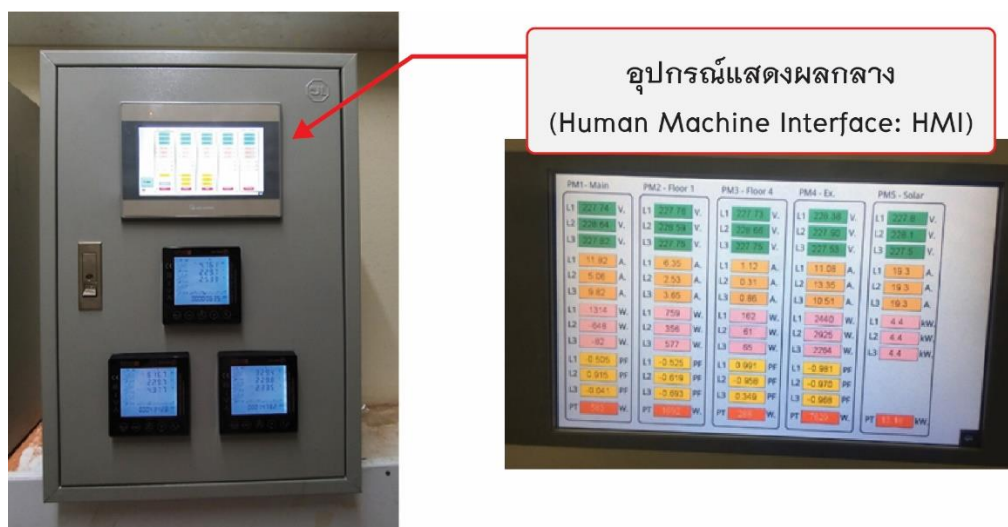
ภาพ 31 แสดงการติดตั้งอุปกรณ์แสดงผลกลาง (Human Machine Interface: HMI)
